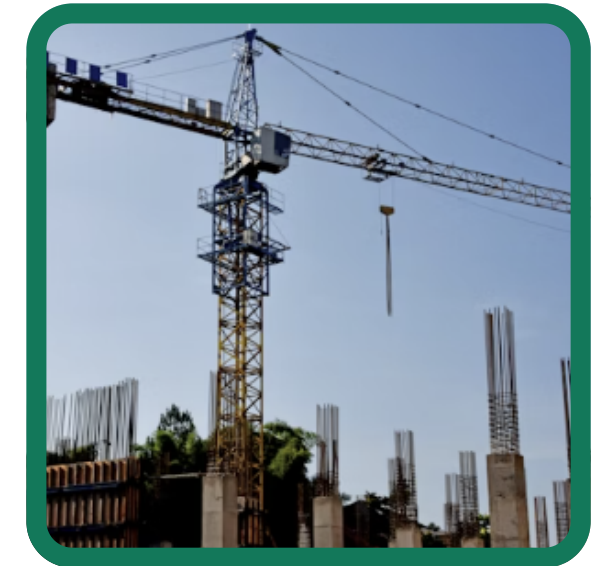
PCMAT – Programa de Condições e Meio Ambiente de Trabalho na Indústria da Construção Civil – NR-18
